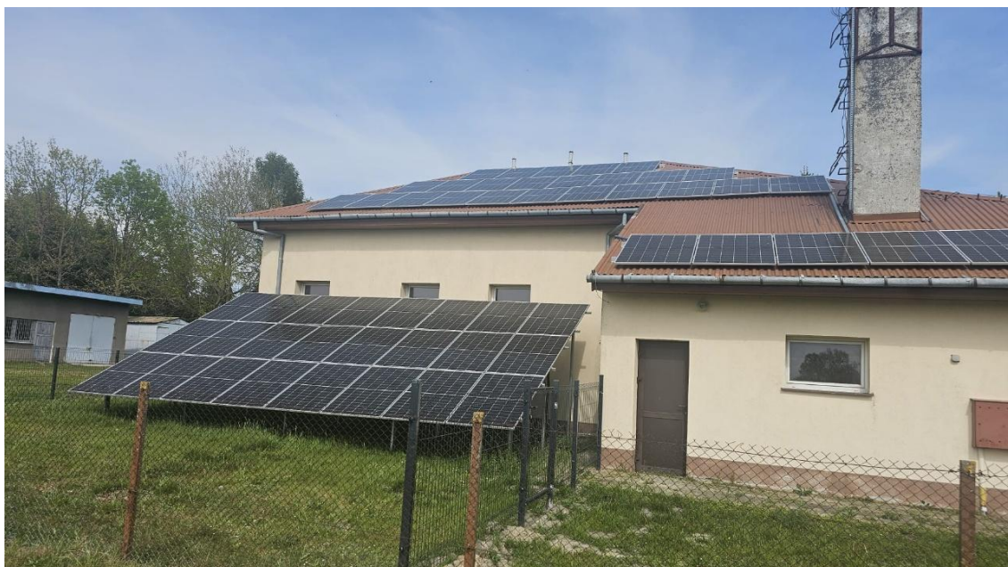
Fotowoltaika na budynku hydroforni w Kozieńcu.
