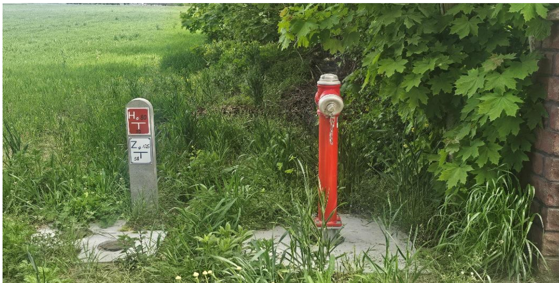
Wodociąg w miejscowości Zwierzyniec.
